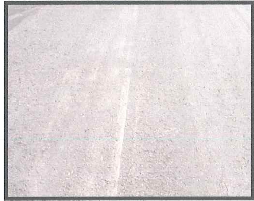
Fotografía No. 12 Vista 1 de marcas en la pista
