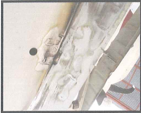
Fotografía No. 9 Vista 1 de compuerta de tren de nariz dañada
