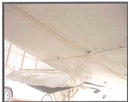
Fotografía No. 4 Vista 2 de flap dañado
