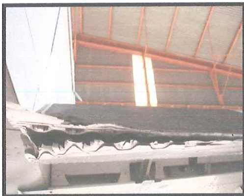
Fotografía No. 3 Vista 1 de flap dañado
